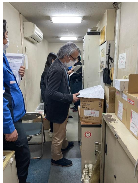
【防災センター内】 館内アナウンス手順の確認
